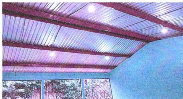
Foto 2: Sistema Eléctrico totalmente instaladas.
